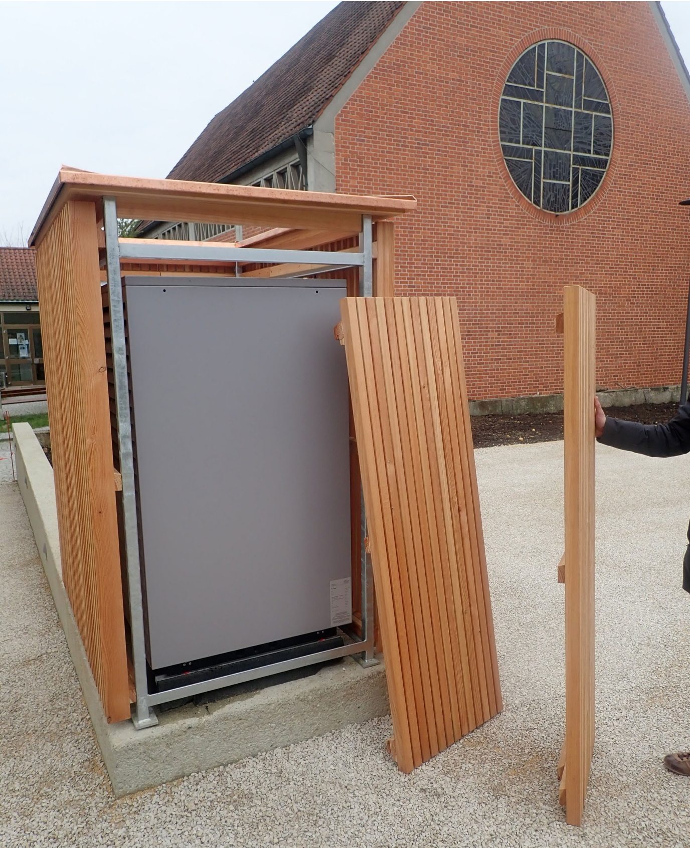
Beispiel Verkleidung Außengerät Wärmepumpe
